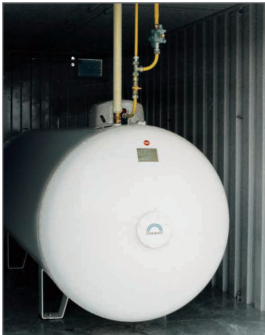
Kreative Lösung für die Baustellenversorgung: Die unabhängige Energie-Versorgungs-Station.
